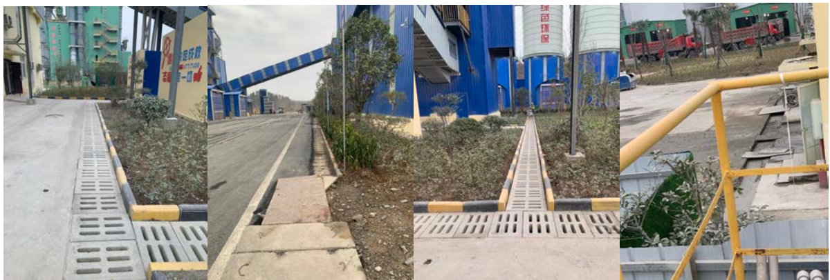
厂区雨水收集管网
