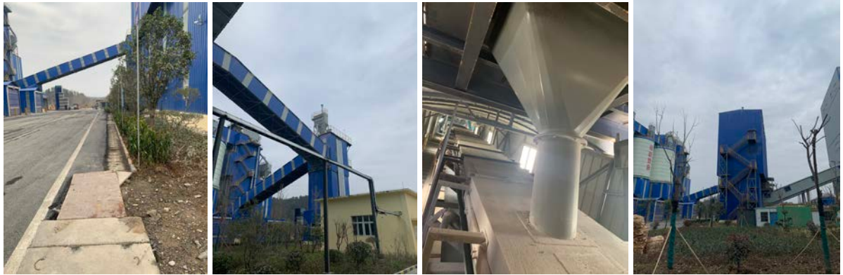
物料密封输送系统 输送拐角除尘器及排气筒 输送系统内除尘器 制砂楼排气筒(共 2 个)
