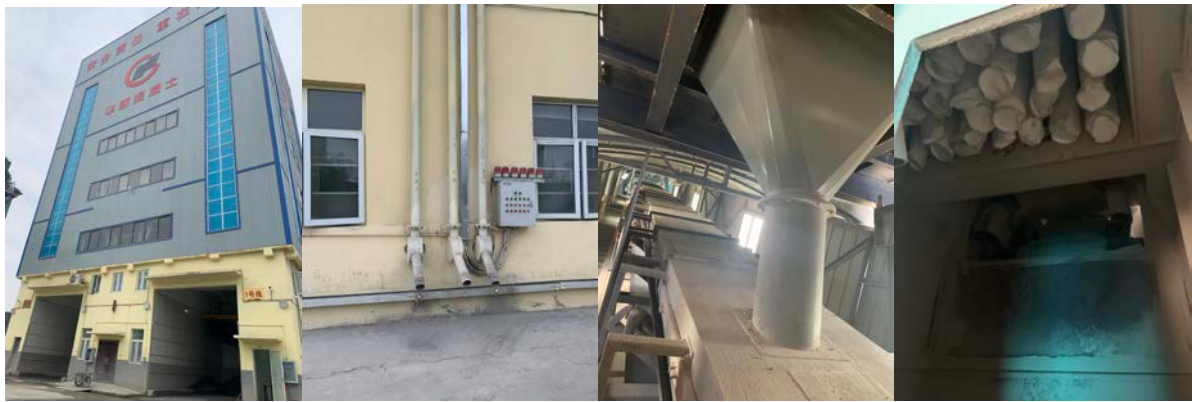
全封闭商砼生产线 粉料密封通管 砂石料封闭输送系统 商砼生产线布袋除尘
